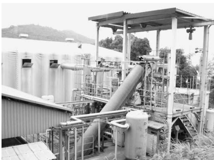
自然エネルギーのひとつバイオマス発電装置
