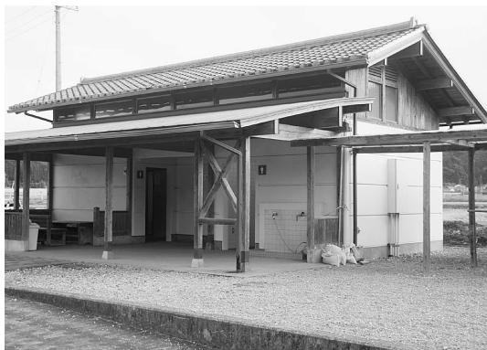
改修が待たれるあおぞら公園トイレ
