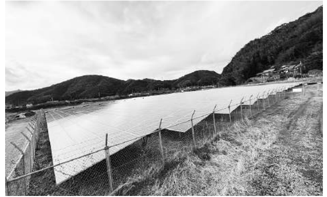
太陽光発電施設
