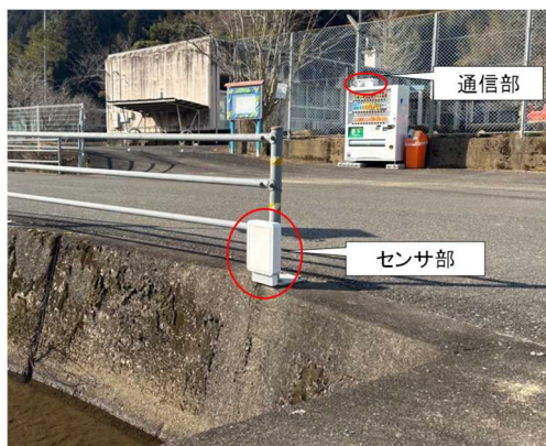
写真11-4 浸水センサ設置事例（西田地区）
