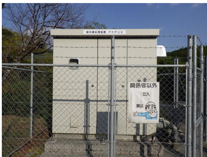
図 3-2 紫外線処理装置（黒岩浄水施設）
