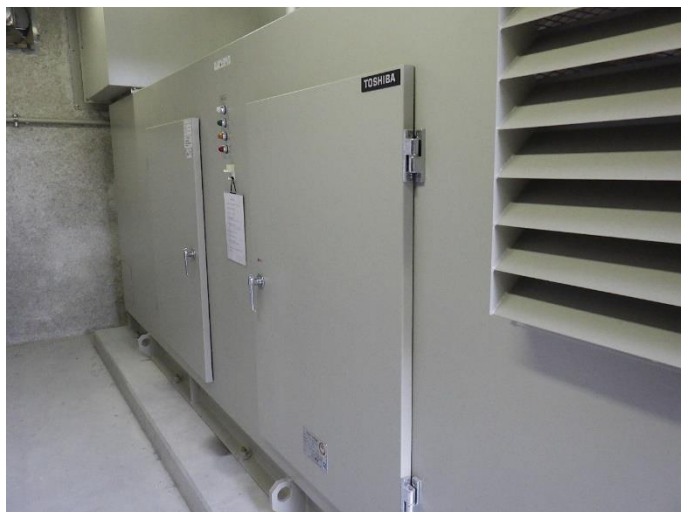
図 3-1 非常用発電設備（新室原水源地）
