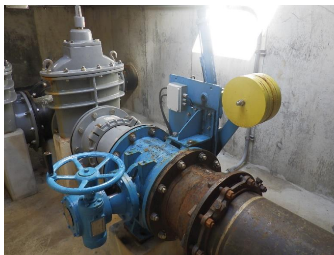
図 3-3 緊急遮断弁（岩井口配水池）
