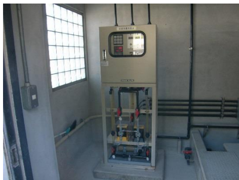
図 3-1-3 塩素滅菌消毒設備（新室原水源地）
