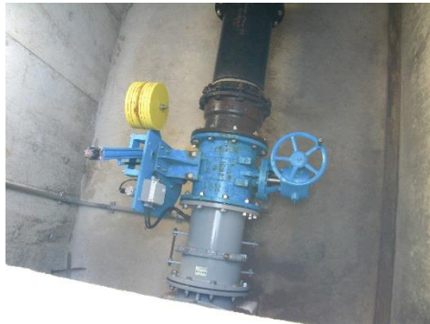
図 3-1-4 緊急遮断弁（岩井口配水池）
