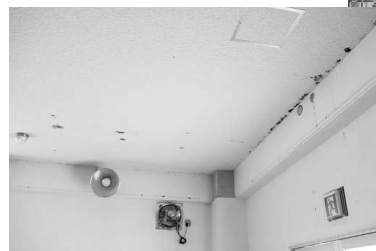
プール天井にカビが！
