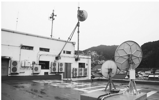
庁舎屋上の無線設備
